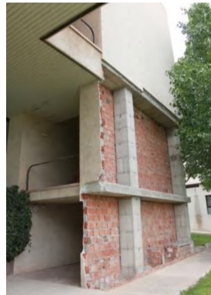
c/ Remplissage de l'hôpital
