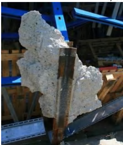
d/ Arrachement de la poutre support
