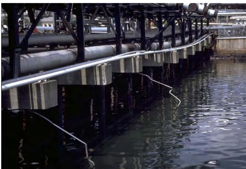
Figure 2-18 : Déformations imposées à une tuyauterie dues à un tassement des fondations (raffinerie de Tupras, Séisme d'Izmit, 1999, [R14])
