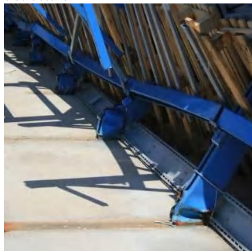
e/ Ruine des poteaux
