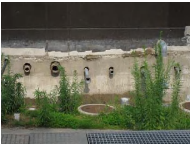
Figure 2-19 : Rupture des tuyauteries au point de jonction entre le bâtiment et le sol (Tohoku, Japon, 2011, [R11])
