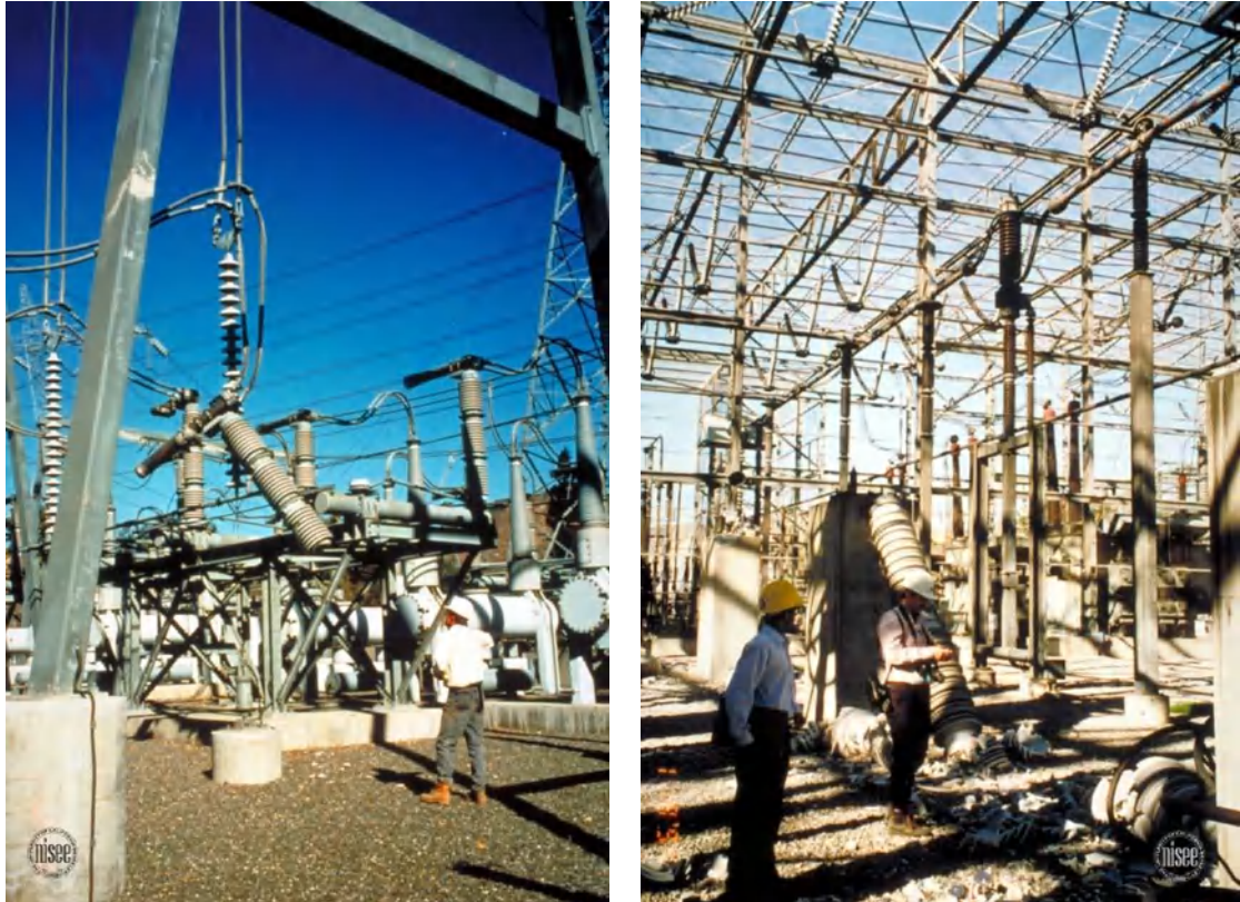
Figure 2-10 : Rupture d'éléments de sous-station électrique (Northridge, USA, 1994, [R13])
