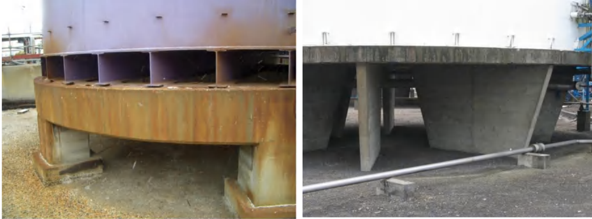
Figure 1-14: Gauche : Réservoirs sur structure porteuse BA (TOTAL), Droite : Réservoirs sur structure porteuse BA (TRACTEBEL)
