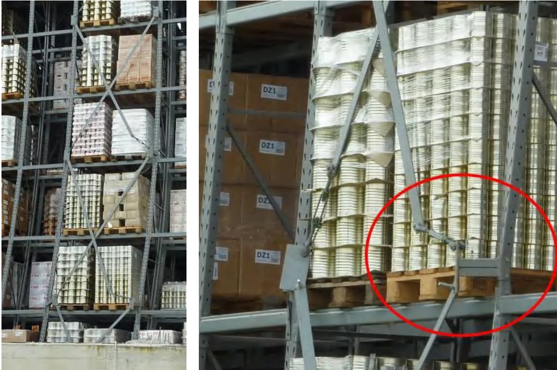
Figure 2-16 : Désordre dans des racks de stockages (Emilie-Romagne, Italie, 2012, [R20])
