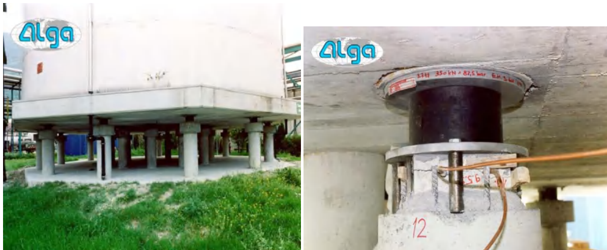
Figure 2-23 : Exemple de réservoir renforcé avec des isolateurs ALGA (Suisse)
