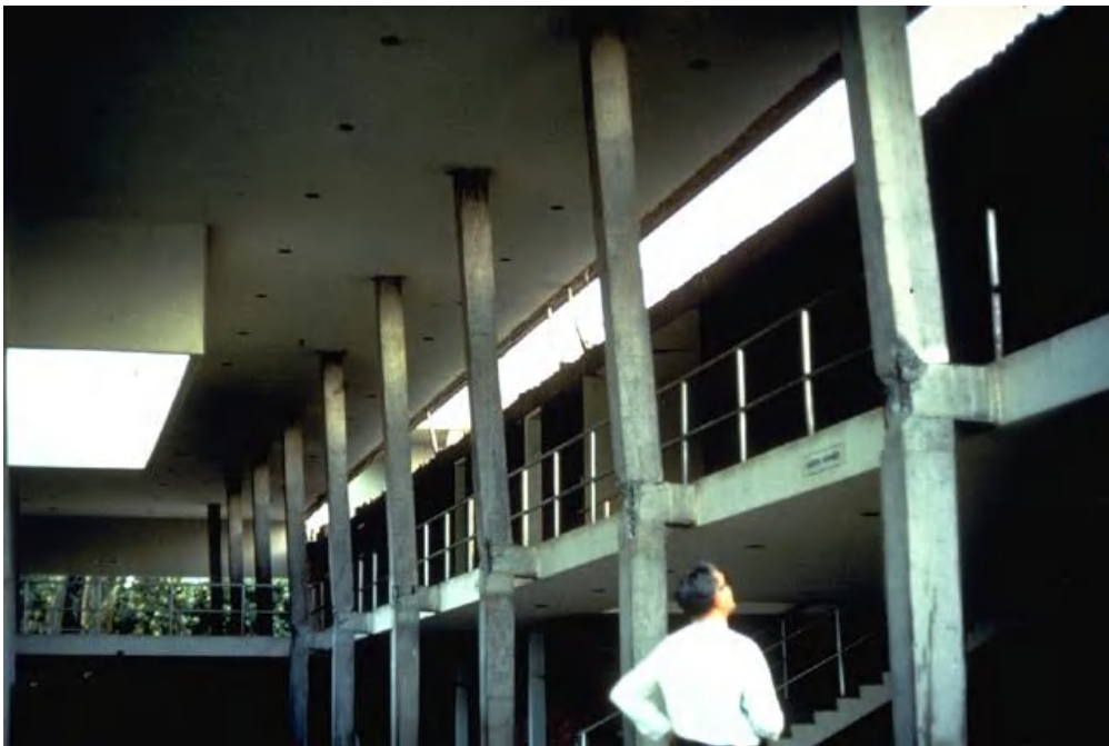
Figure 2-2 Portiques et voiles en béton armé industriel (Ceyhan, Turquie, 1998)
