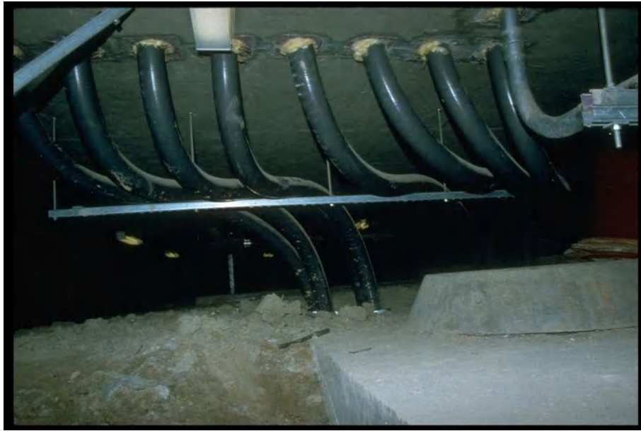
c/ Tuyauterie flexible permettant d'absorber les déplacements différentiels
