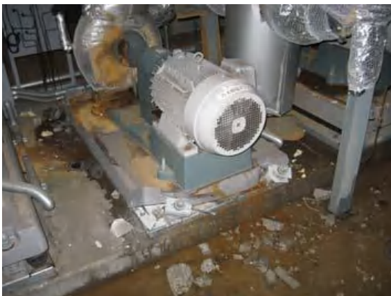
a/ Dommage à la base d'une pompe
