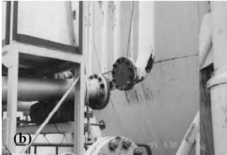
Figure 2-14 : Rupture d'une tuyauterie par déplacement différentiel imposé (d'après [R9])
