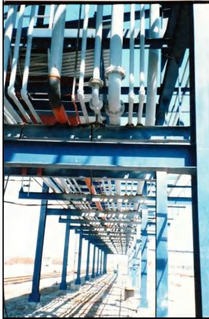
Figure 2-12 : Support de rack – à Lazaro Cardenas – Séisme du Mexique 1985 (accélération d'environ 0.3 à 0.4g), Source : AFPS
