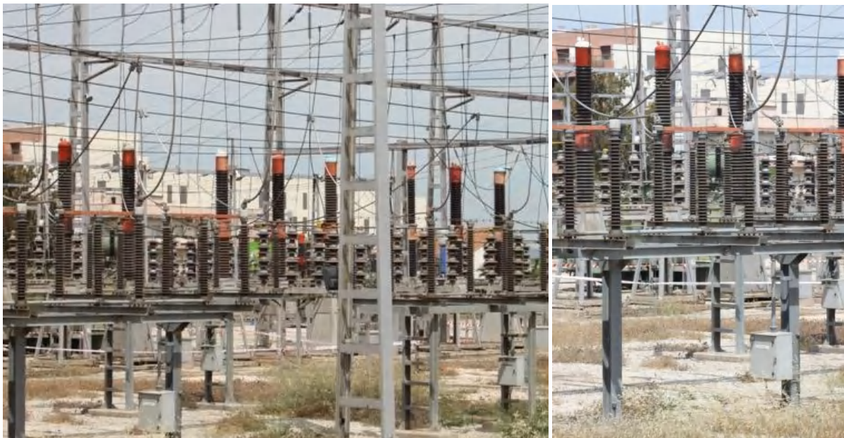
Figure 2-9 : Supports métalliques d'isolateurs électriques en céramique (Lorca, Espagne, 2011, [R19])
