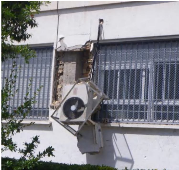
a/ Maçonnerie non structurale supportant un équipement de ventilation
