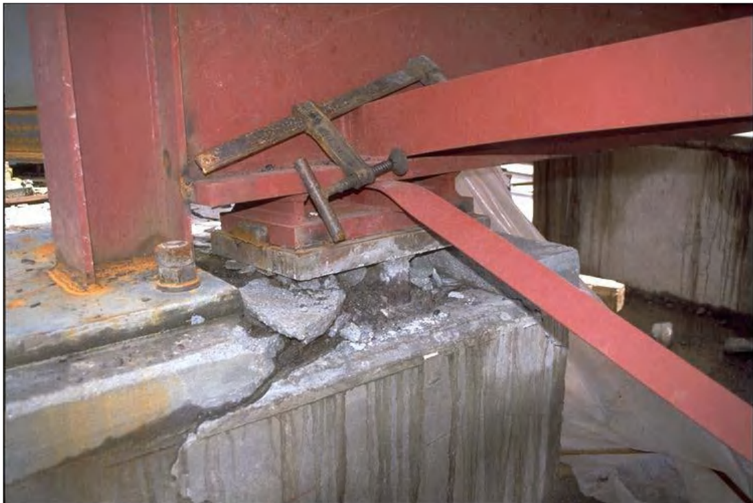
Figure 2-17 : Rupture des ancrages d'un support de « boiler », EnerjiSA, (Izmit, Turquie, 1999, [R14])
