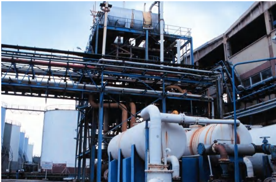
Figure 1-17 : Rack aérien, mission post-sismique AFPS d'Izmit (1999)
