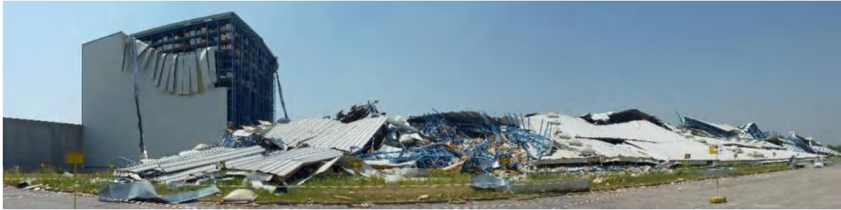
a/ Effondrement partiel
