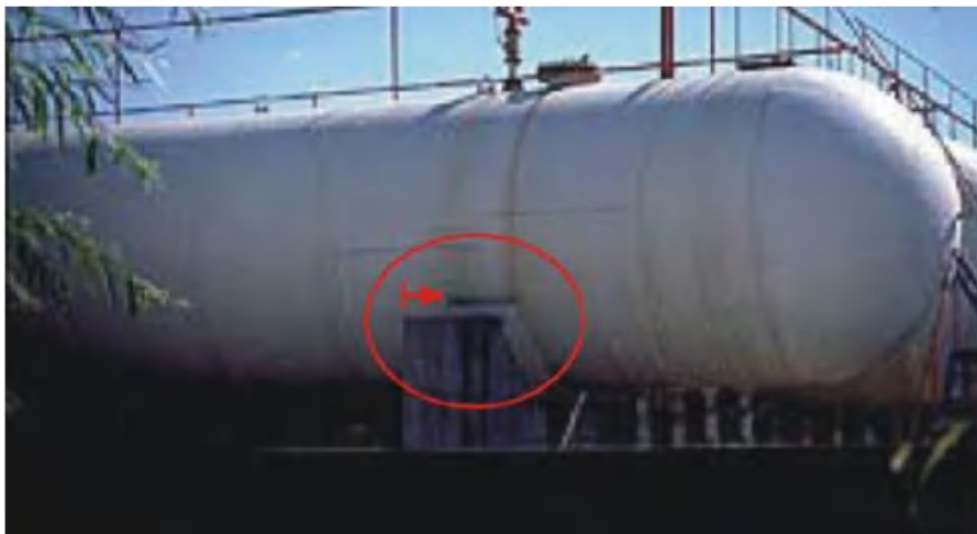
Figure 2-11 : Glissement d'un réservoir horizontal sur ses appuis en béton (Izmit, Turquie, 1999, [R14])
